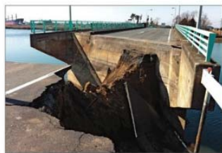
図1 地震によって破壊された橋。
